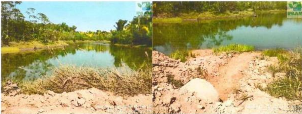
Figuras 20 e 21: Vista de alterações causadas pela instalação de manilhas de forma irregular.
