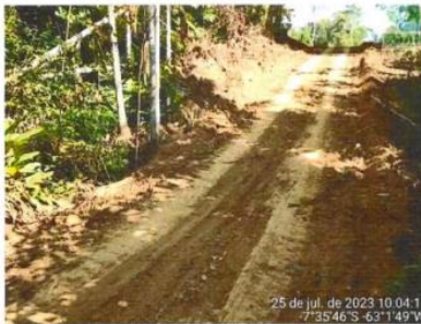
Figura 17: Transposição do curso d'água obstruída pelo aterro da pista.
