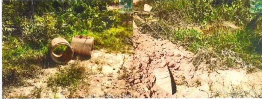
Figuras 13 e 14: Manilhas de concreto não instaladas. Transposição do curso d'água realizada por meio de tronco de árvore oca instalada acima da cota do leito regular.
